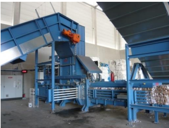
Abbildung 3: Sortieranlage und Kanalballenpresse Deißlingen
